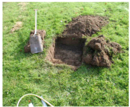
Der udgraves mindst 2 prøvehuller ned til det niveau, hvor faskinen skal ligge. Selve prøvehullet skal være min. 0,25 m x 0,25 m og mindst 0,3 m dybt. Hullerne skal ligge mindst 5 m fra hinanden
